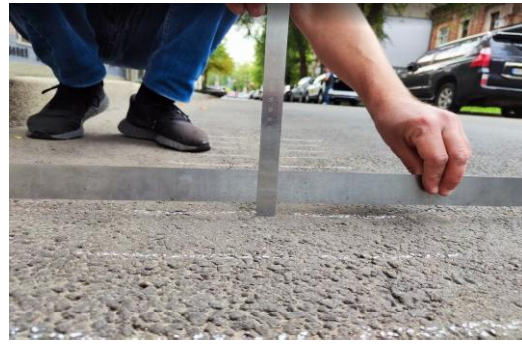
Рис. 3. Інструментальне вимірювання дефекту дорожнього одягу
